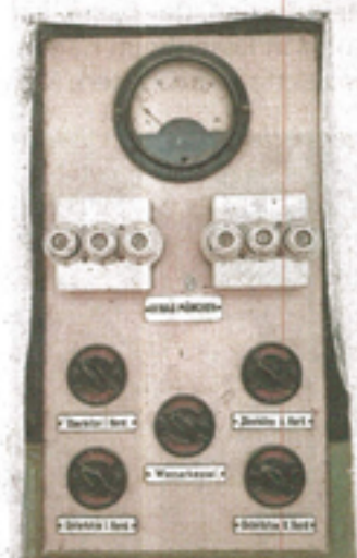
Ein Blick auf die Technik des Hauses.
